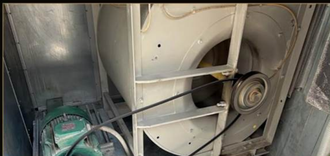
DRIVE & FAN INSPECTION
